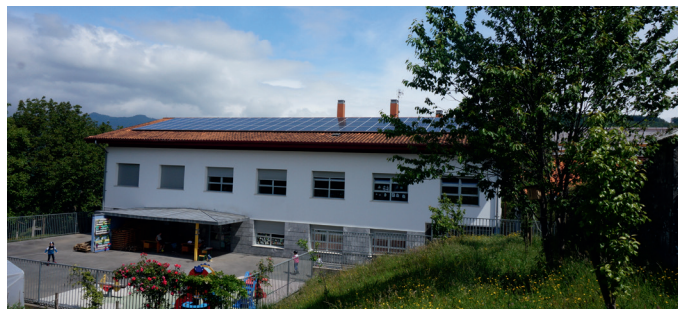
Eskolako teilatuko instalazio fotoboltaikoa
